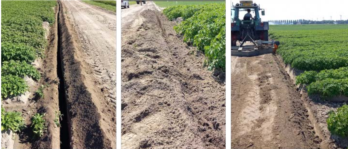
Figuur 2.5 Aanleg van een verdiepte en gevulde infiltratiegreppel. Eerst werd de aanwezige afvoergreppel verdiept m.b.v. een sleuvenfrees (links), de sleuf werd gevuld met bomenzand (midden) en werd vervolgens weer in V-vorm afgewerkt (rechts).
