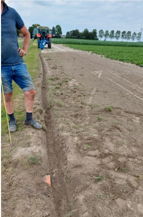
Figuur 4.7 Aanleg van de dubbele greppel. De eerste greppel ligt vlak voor het gewas langs (rode lijn, rechts op de foto). De tweede greppel ligt aan de andere kant van het kavelpad, voor de sloot (links op de foto, bij de man).
